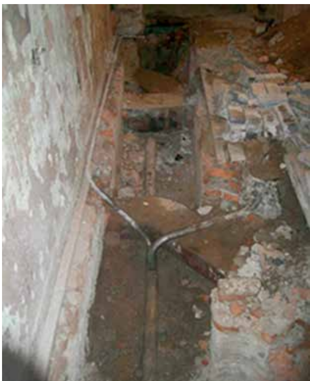
Рис. 5. Трубопроводы старой системы спецканализации в помещении № 49 петлевой установки АСТ
