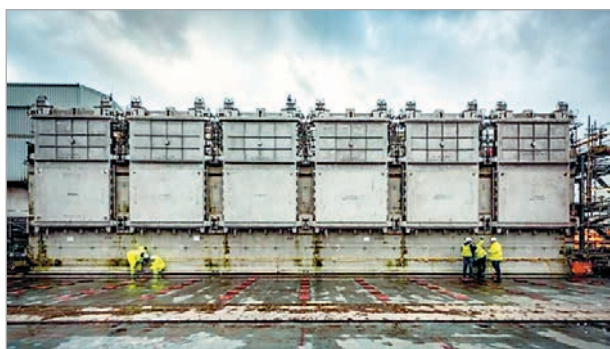
Рис. 7. Шесть стальных дверей, установленных в сухом хранилище оболочек твэлов Уиндскейл Пайл в Селлафилде (Великобритания)
