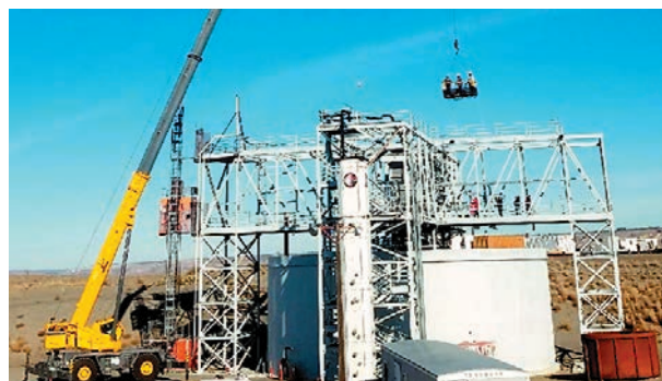
Рис. 2. 150-тонный кран повышенной проходимости, опускающий лифтеров и электриков в шахту тестовой установки для проведения холодных испытаний
